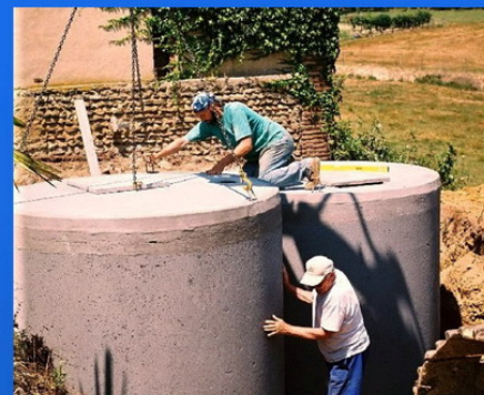
Citernes de récupération d'eau de pluie
