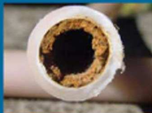
Tuyau encombré de boue et de dépôts
