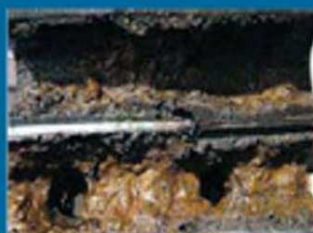
Echangeur obstrué par de la boue
